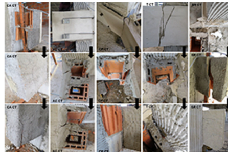
Figura 5 - Rompimentos e fissuras na interface com tela no revestimento
