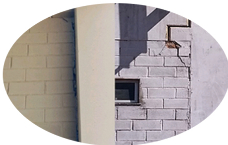
Figura 1 - Manifestações patológica de fissuras na ligação entre estrutura de concreto armado pré-moldado e alvenaria de vedação
