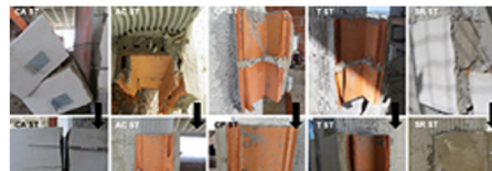
Figura 6 - Rompimentos e fissuras na interface sem tela no revestimento
